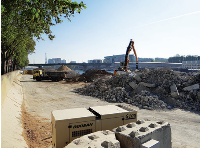
Berges de Seine : gestion de déchets du BTP au port du Point du Jour, Paris 16 e
