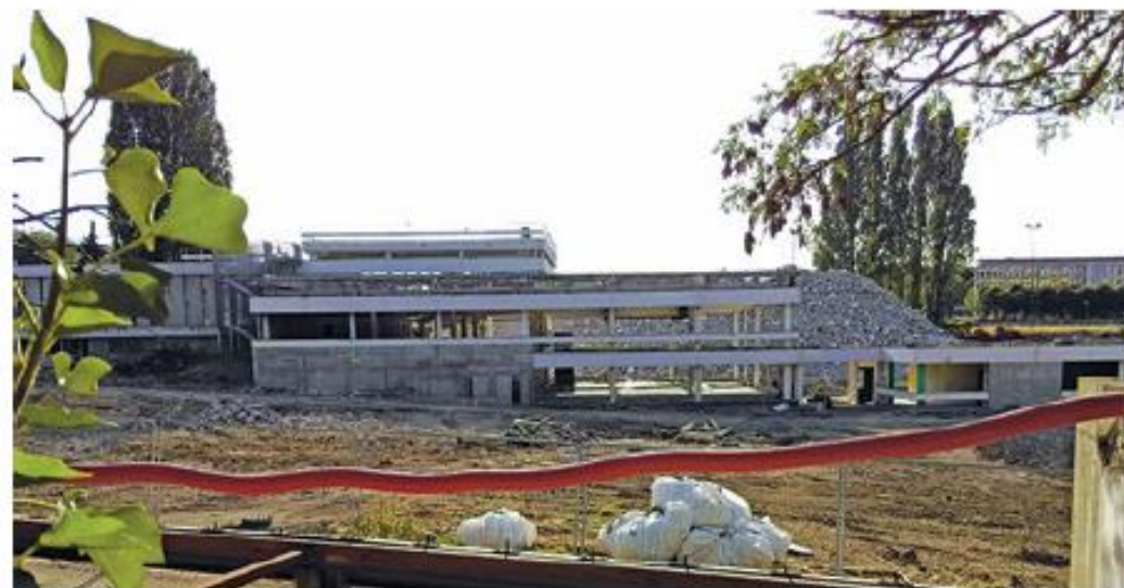
Démolition de l'ancienne école Centrale Paris, Châtenay-Malabry (exemple de valorisation de béton)
