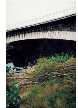
Port de Tolbiac (Paris 13 e ), aval du pont National, Berge non maçonnée avec un arbre au sol gênant le passage. Matériaux entassés en vrac sous le pont. Vue vers l'amont.
