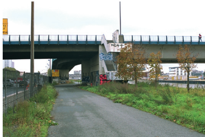
Pont Nelson Mandela amont (Charenton-Le-Pont), escalier d'accès au pont, vue vers l'amont. Nombreux graffitis.
