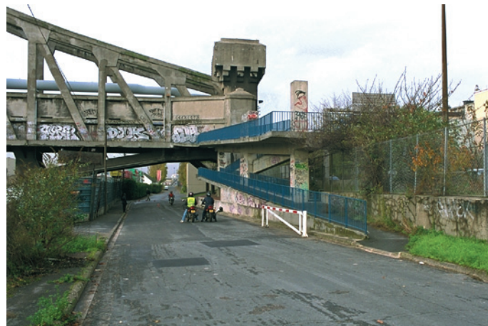
Quai de Charenton (Charenton-Le-Pont), rampe d'accès à la passerelle des câbles. Nombreux graffitis.
