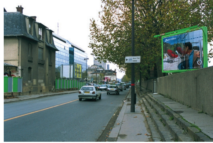
Quai Panhard et Levassor (Paris 13 e ), vue vers l'aval. Trottoir dégradé et étroit. Mur anti-crue bordé par 3 marches. Travaux de réaménagement des quais.
