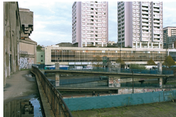
Rampe d'accès vue de la passerelle des câbles (Charenton-Le-Pont). Passage des piétons et cyclistes possible sur la passerelle ; aspect dégradé et graffitis.
