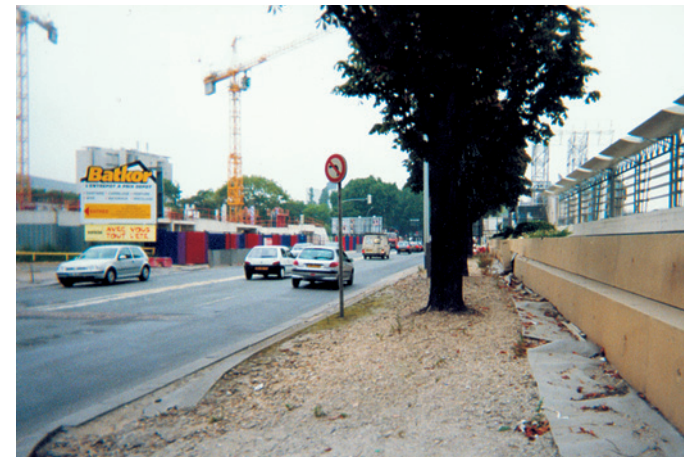
Quai Marcel Boyer (Ivry-sur-Seine). Trottoir dégradé le long de la promenade du port. Vue vers l'aval. ZAC d'Ivry Port côté bâti.
