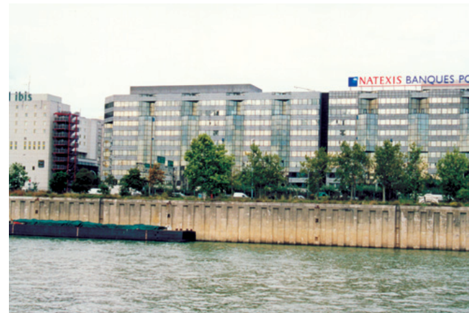
Aval des ponts Nelson Mandela (Charenton-Le-Pont), vue depuis la rive gauche. Absence de berge.
