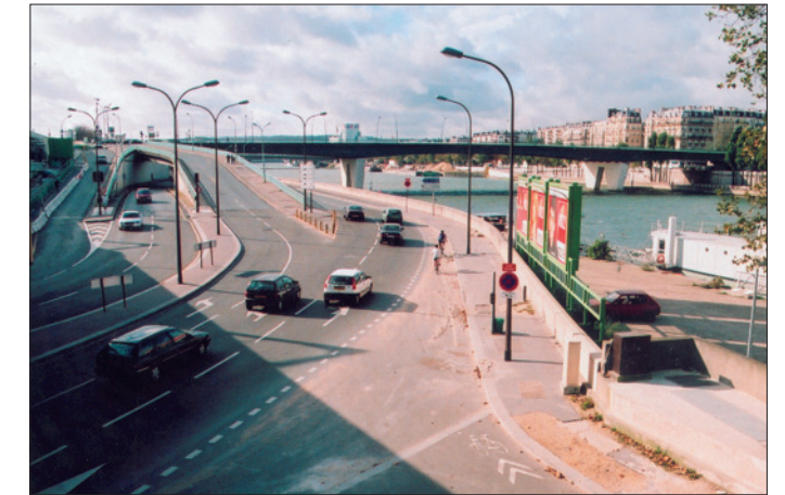
Échangeur du Pont du Garigliano, aménagement en cours de la bande cyclable le long du trottoir de la station du RER bd Victor.
