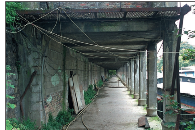
Chemin de la berge végétale du bras d'Issy-Les-Moulineaux, passage sous porche sous un bâtiment dégradé.
