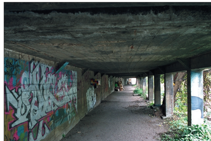
Chemin de la berge végétale du bras d'Issy-Les-Moulineaux, aspect dégradé du bâtiment et faible hauteur sous plafond.
