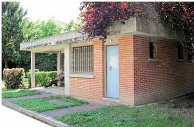
Abri sanitaire : démolition à envisager
