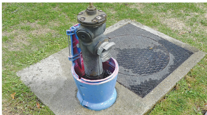
Borne de service et utilitaire équipé pour l'arrosage, alimentés en eau potable - Épinay-sur-Seine
