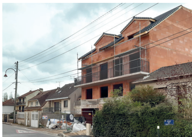
Arrivée de l'habitat collectif dans les tissus pavillonnaires dans les zones mixtes, avenue des Coquelicots, Montfermeil Franceville
